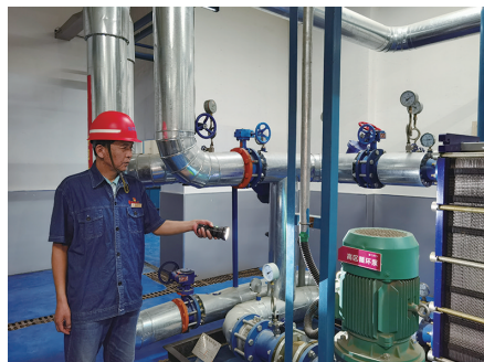
郑州热力集团工作人员检查换热站供热设备
