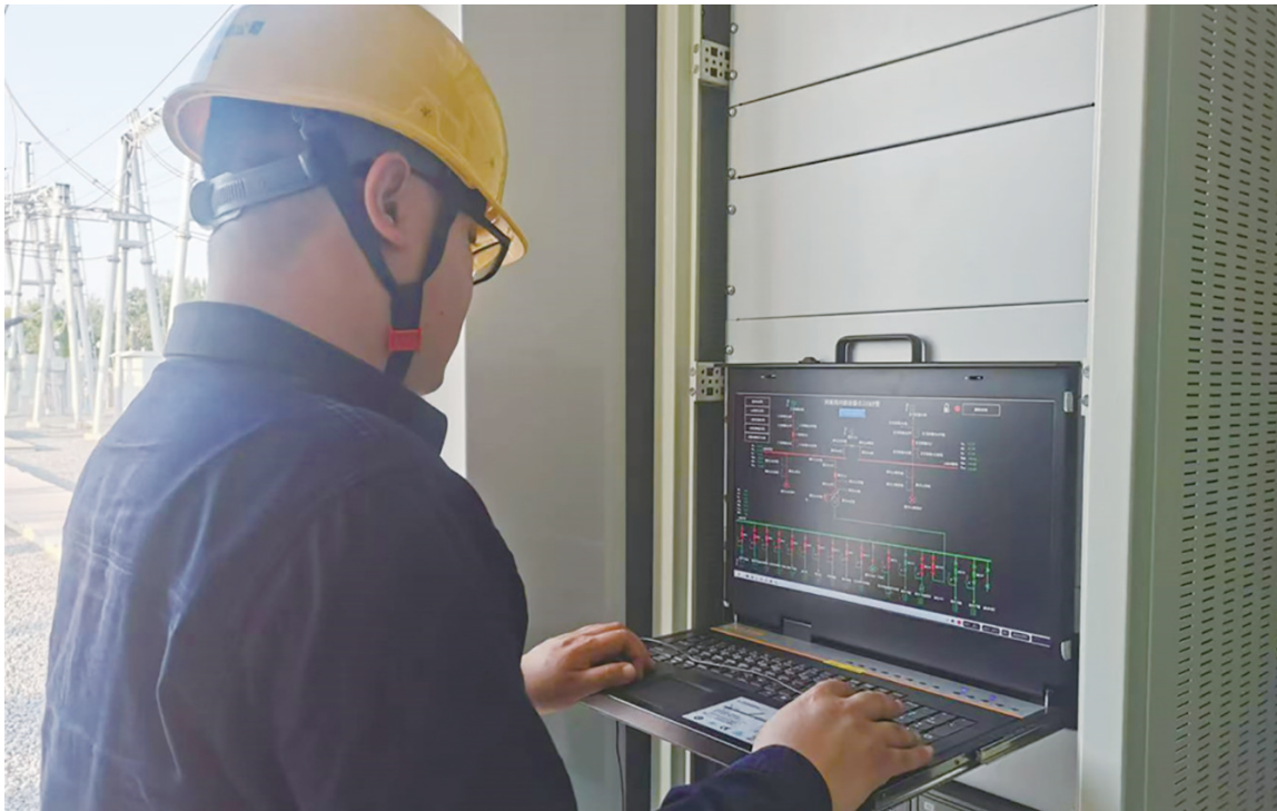
二次设备舱内,运维人员进行「一键顺控」模拟操作
