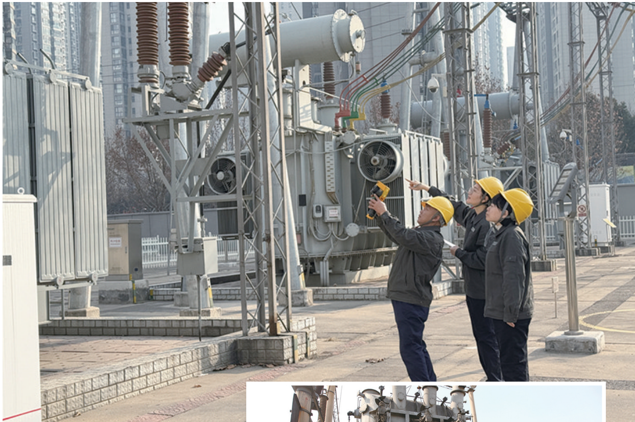
工作人员在改造后的牛砦变电站巡视设备
